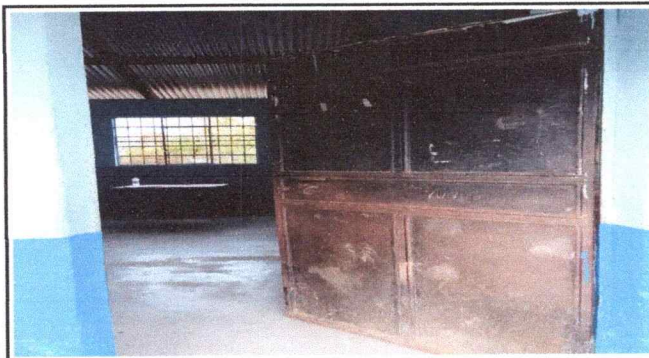
Foto 3: CHAPAS EN MAL ESTADO
